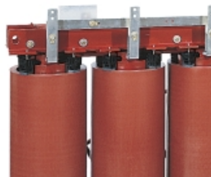
Контактные площадки НН
